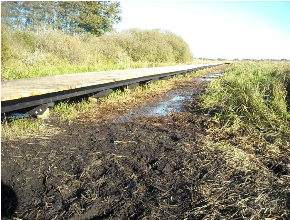
Foto af lignende brokonstruktion (rækværk mangler)
